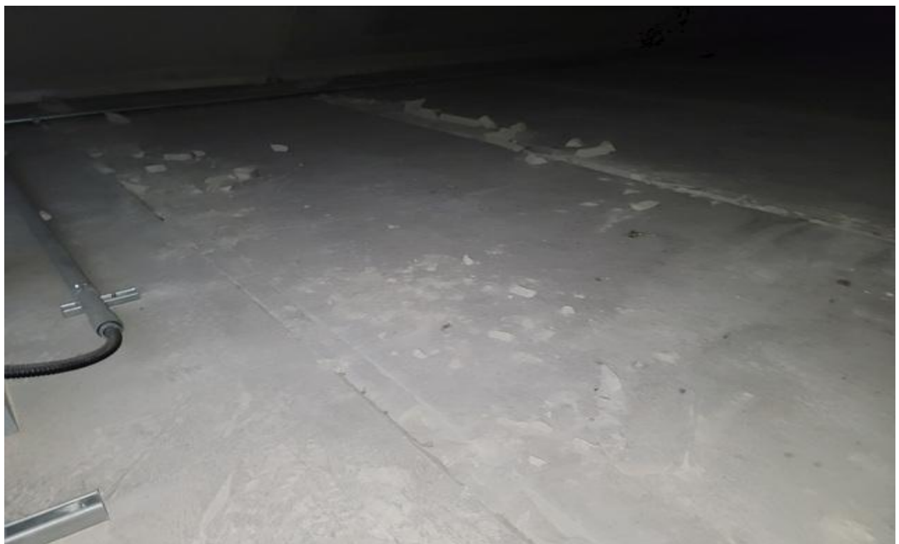
풍도슬래브 상면 S53 이음부 물탈파손
