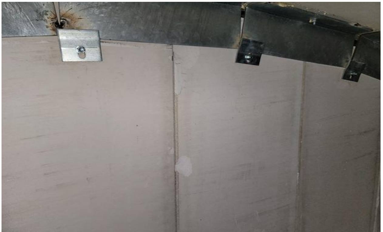
풍도슬래브 격벽 S54 파손
