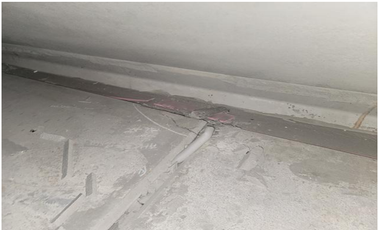
풍도슬래브 상면 S53 파손
