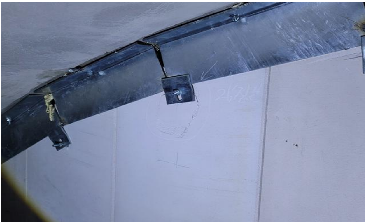
풍도슬래브 격벽 S54 파손
