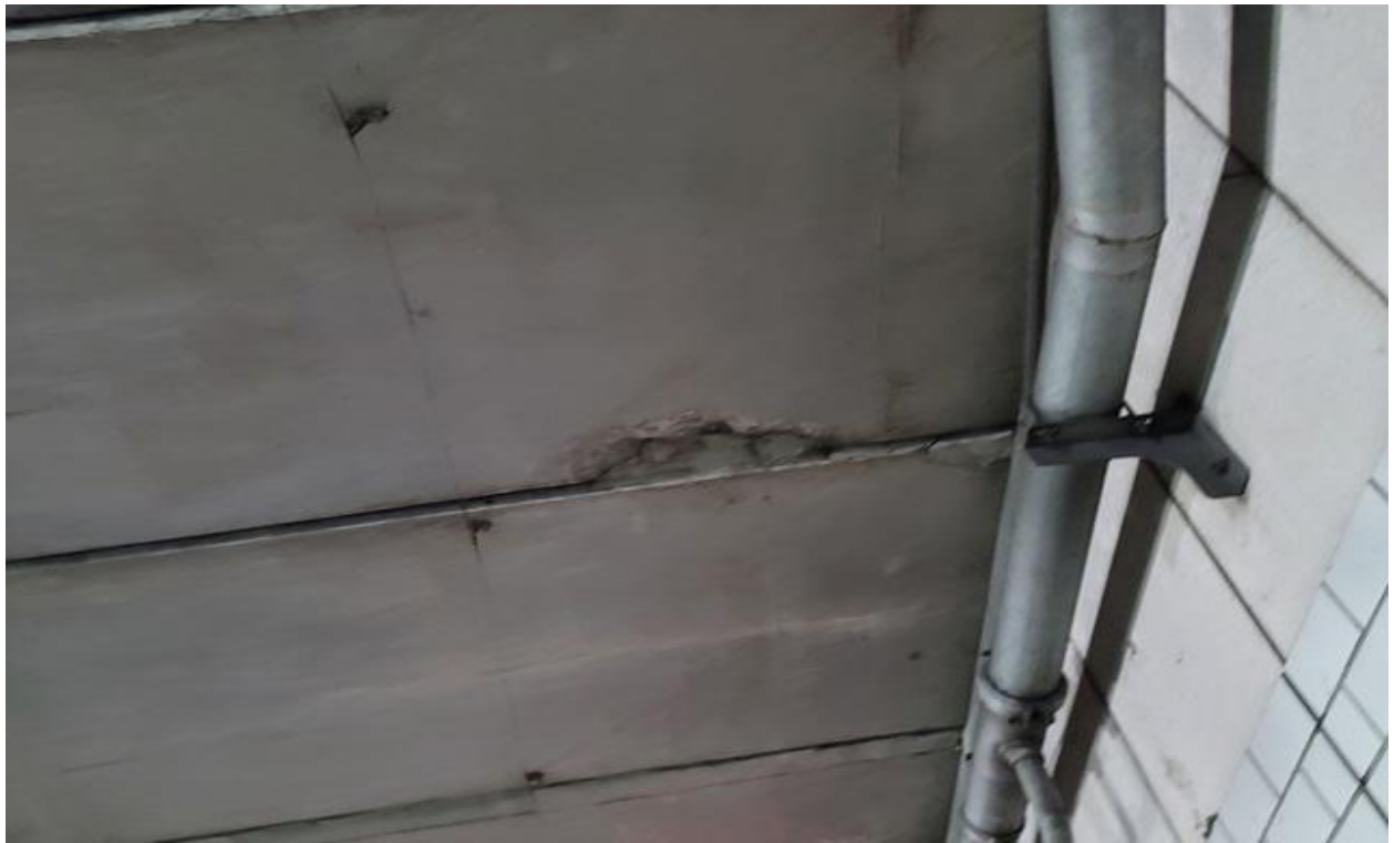
풍도슬래브 하면 S54 파손
