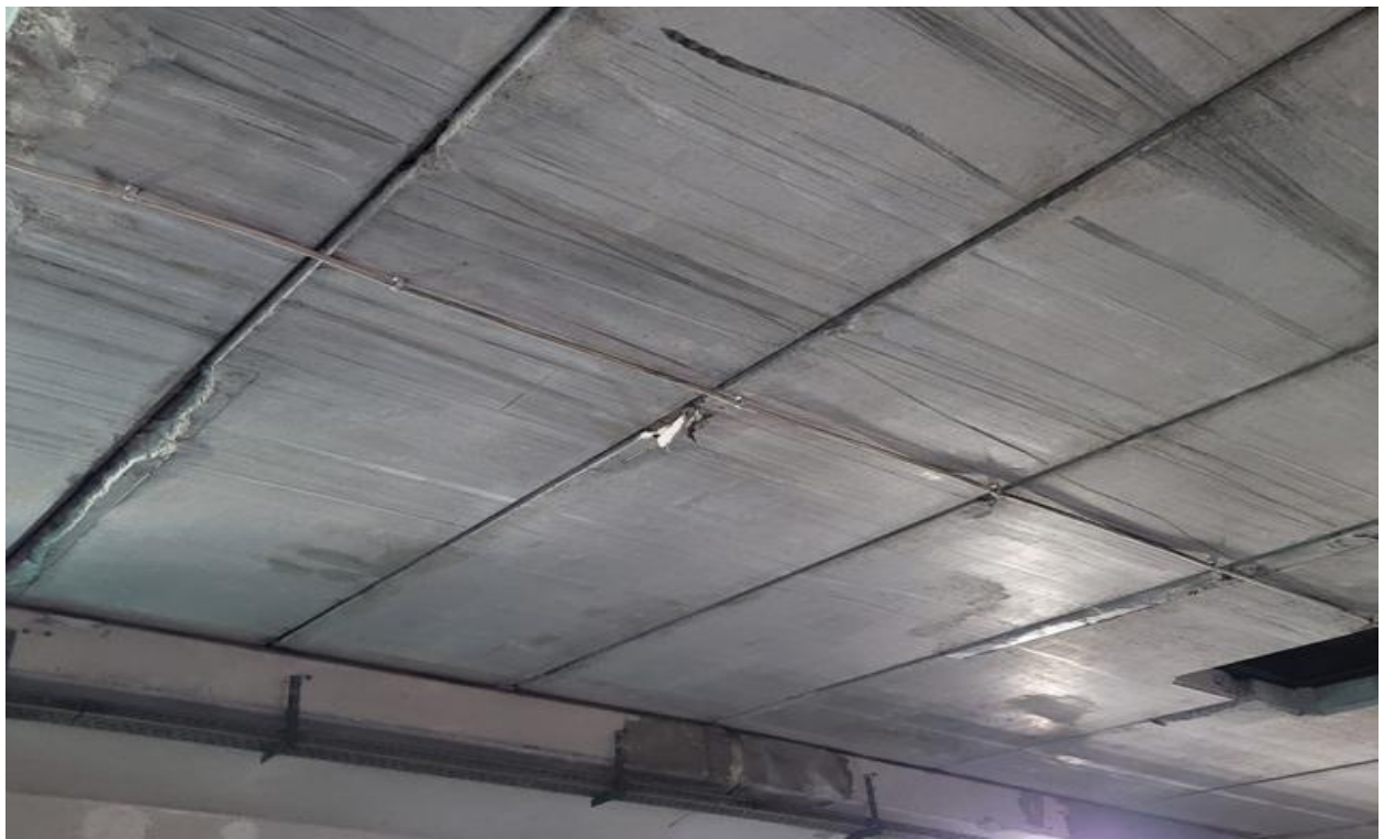
풍도슬래브 하면 S54 파손
