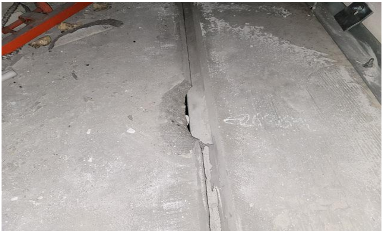
풍도슬래브 상면 S54 파손
