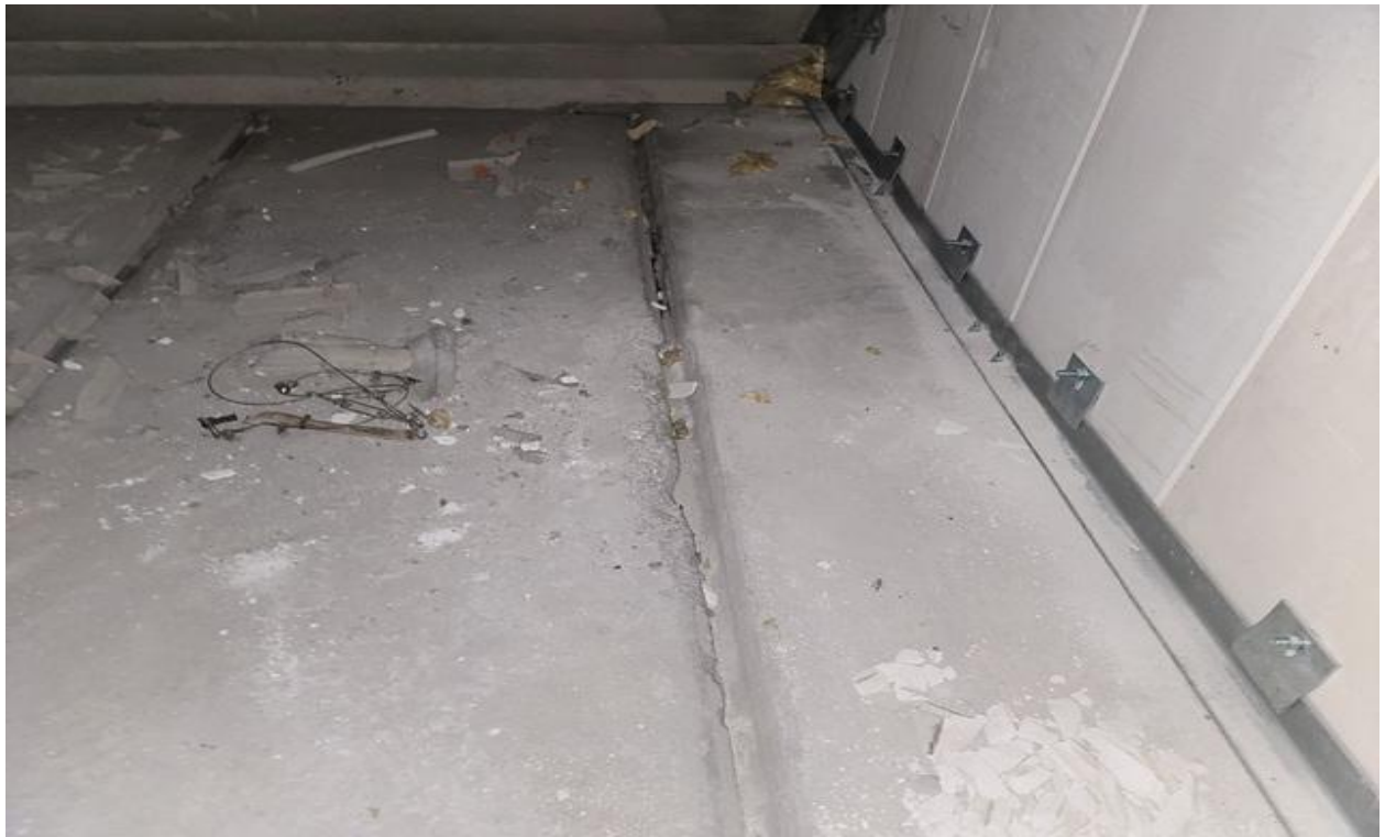
풍도슬래브 상면 S54 파손
