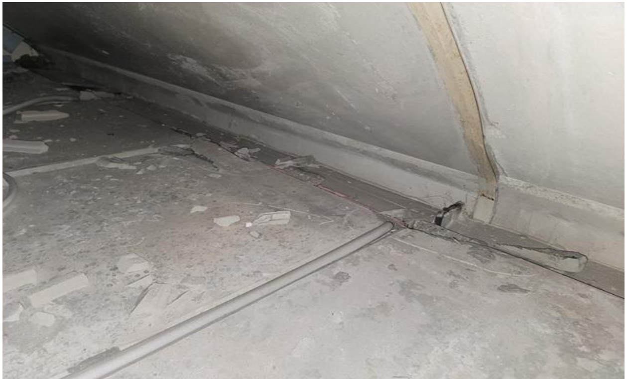
풍도슬래브 상면 S54 파손
