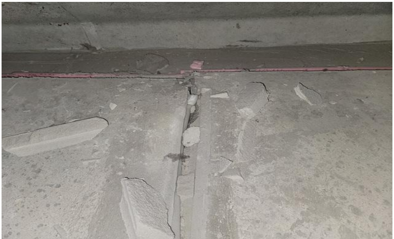
풍도슬래브 상면 S54 파손
