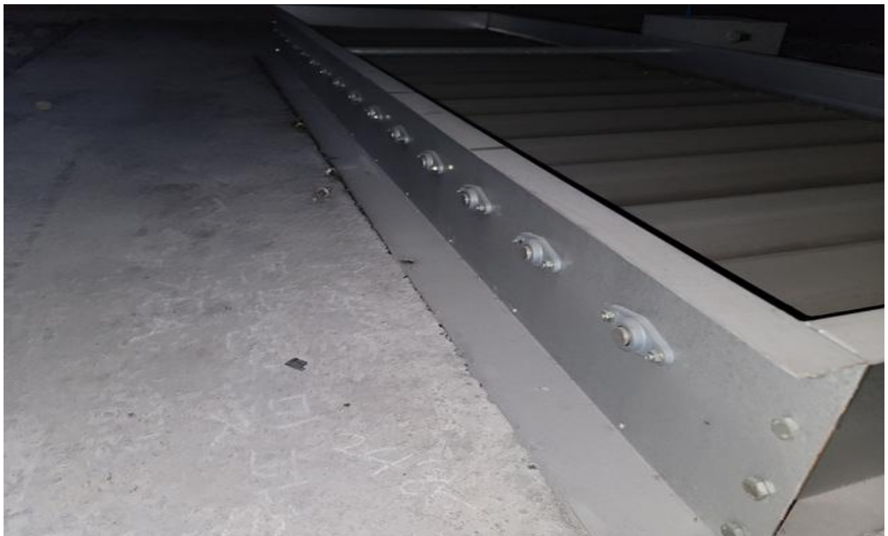
풍도슬래브 상면 S53 댐퍼 볼트탈락 및 파손
