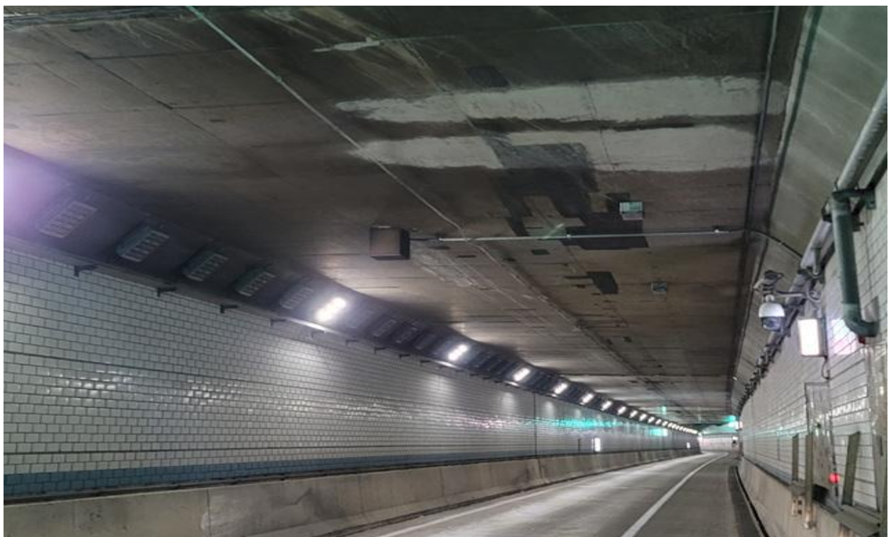
부대시설 S59 신호기 상태양호
