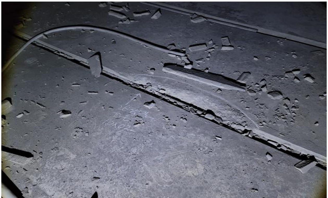
풍도슬래브 상면 S54 파손
