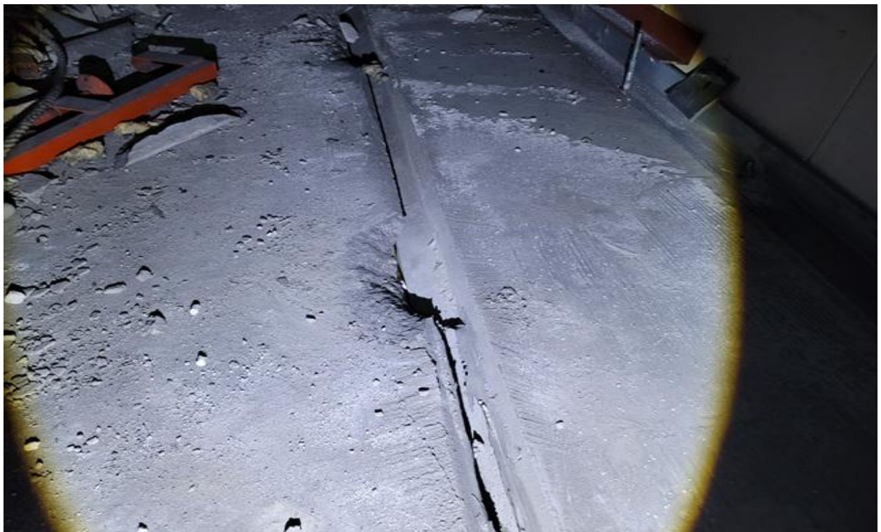
풍도슬래브 상면 S54 파손
