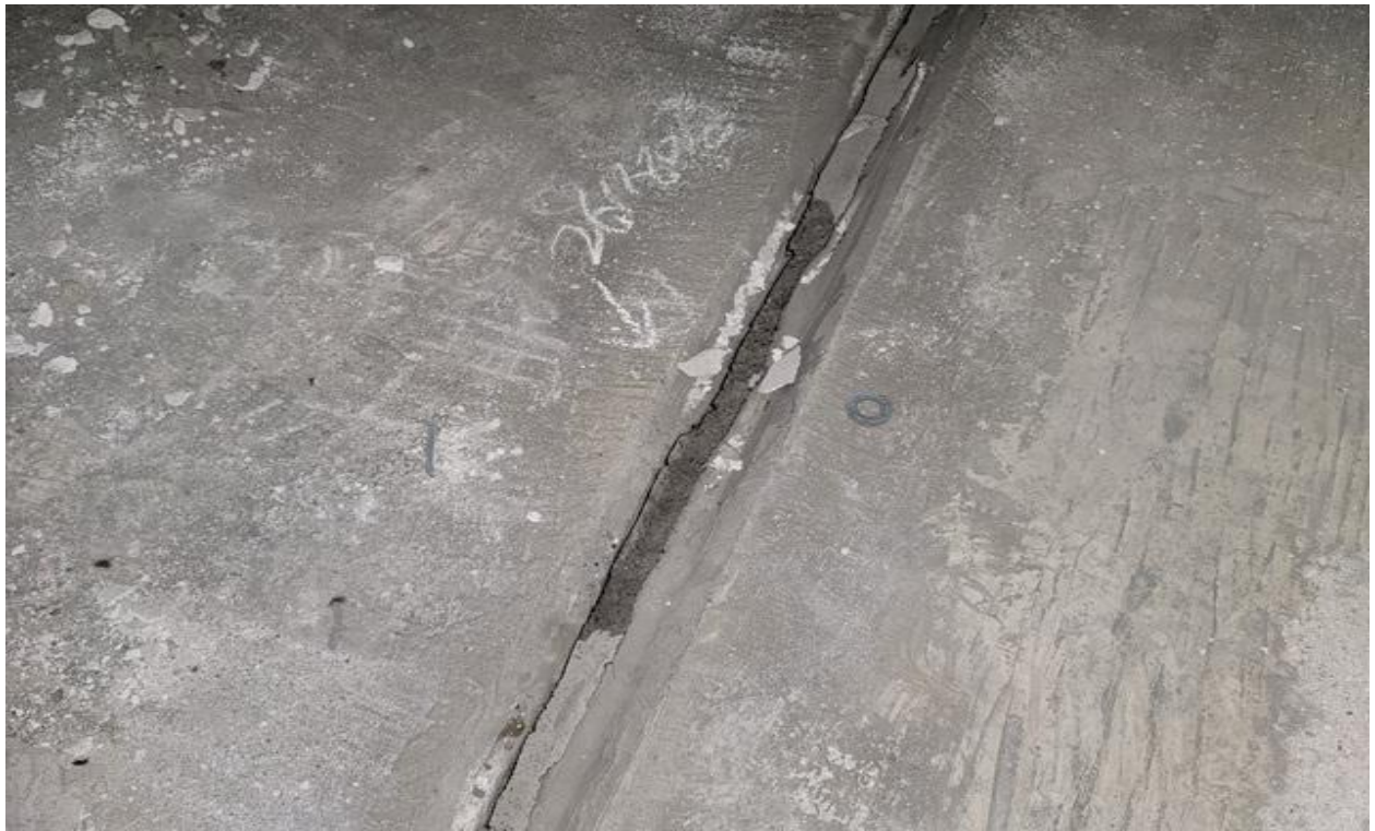
풍도슬래브 상면 S54 파손
