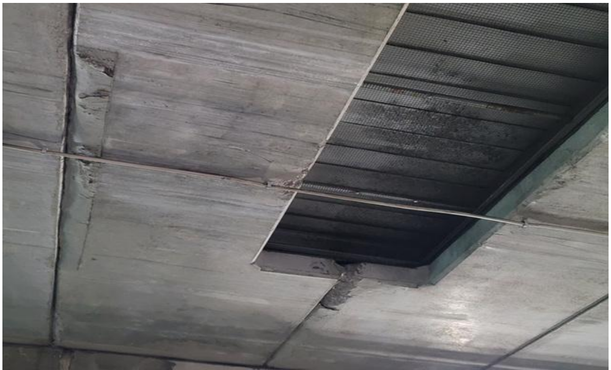
풍도슬래브 하면 S53 파손
