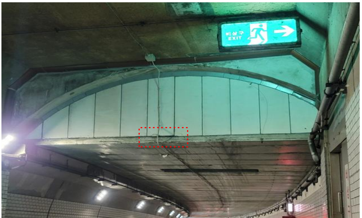
풍도슬래브 격벽 S54 파손
