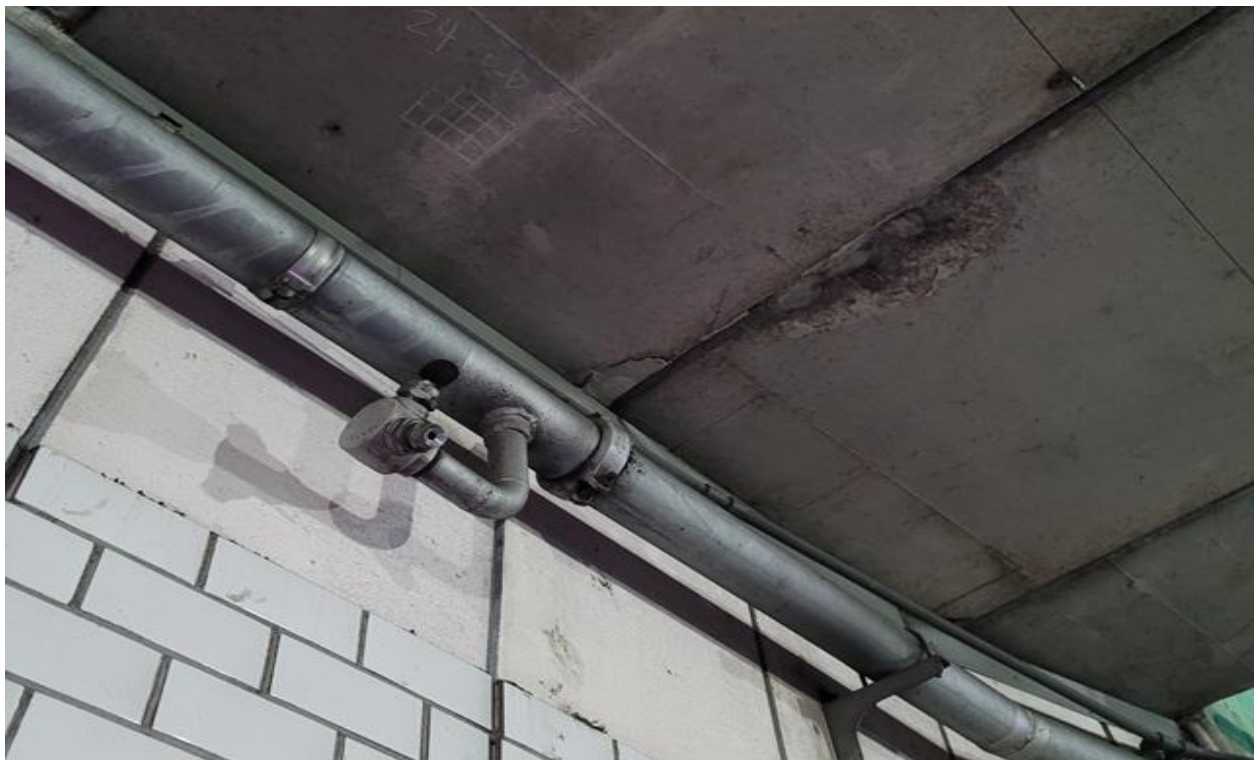
풍도슬래브 하면 S54 파손
