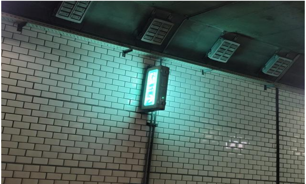
부대시설 S57 비상구 표지판 상태양호
