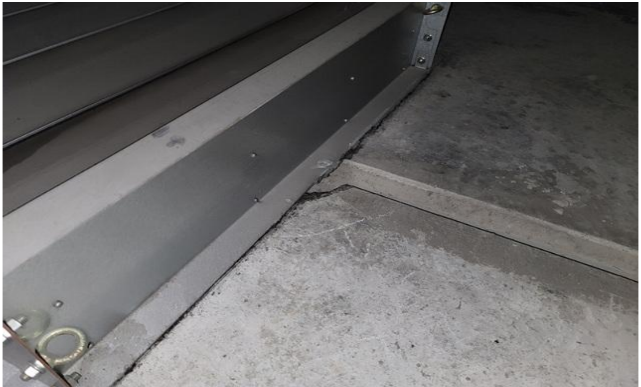
풍도슬래브 상면 S53 파손
