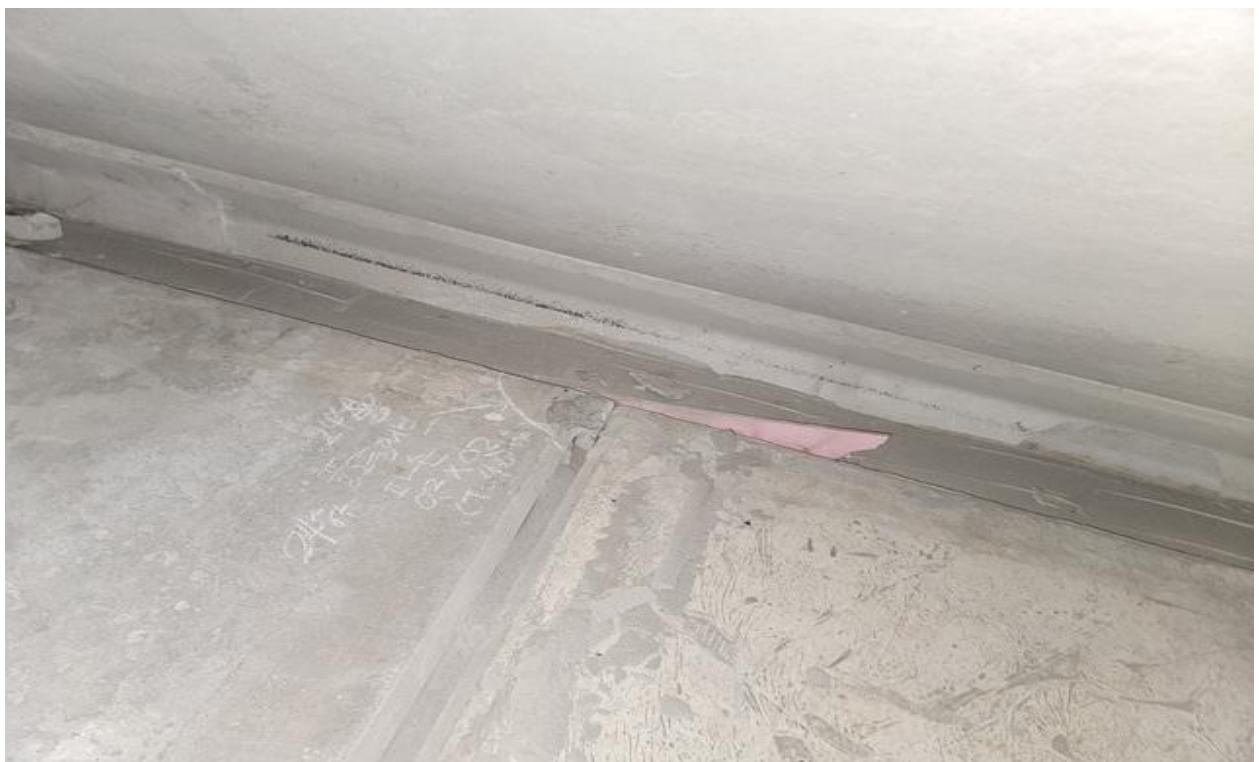
풍도슬래브 상면 S53 파손
