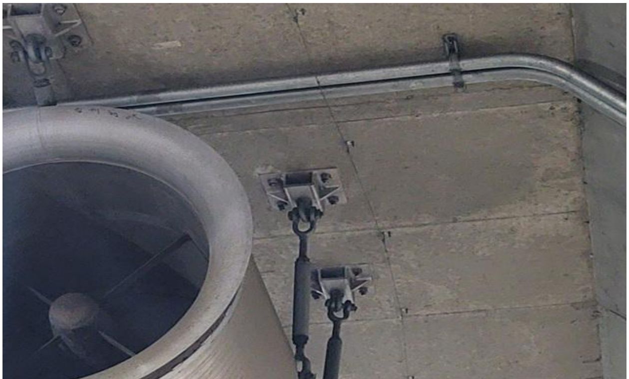
부대시설 S56 제트펜 볼트 상태양호
