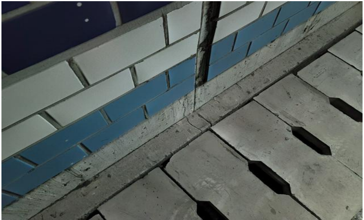
NATM구간 측벽부 S49 파손
