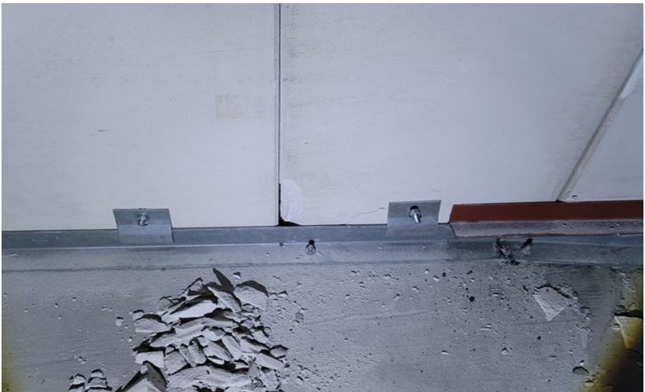
풍도슬래브 격벽 S54 파손
