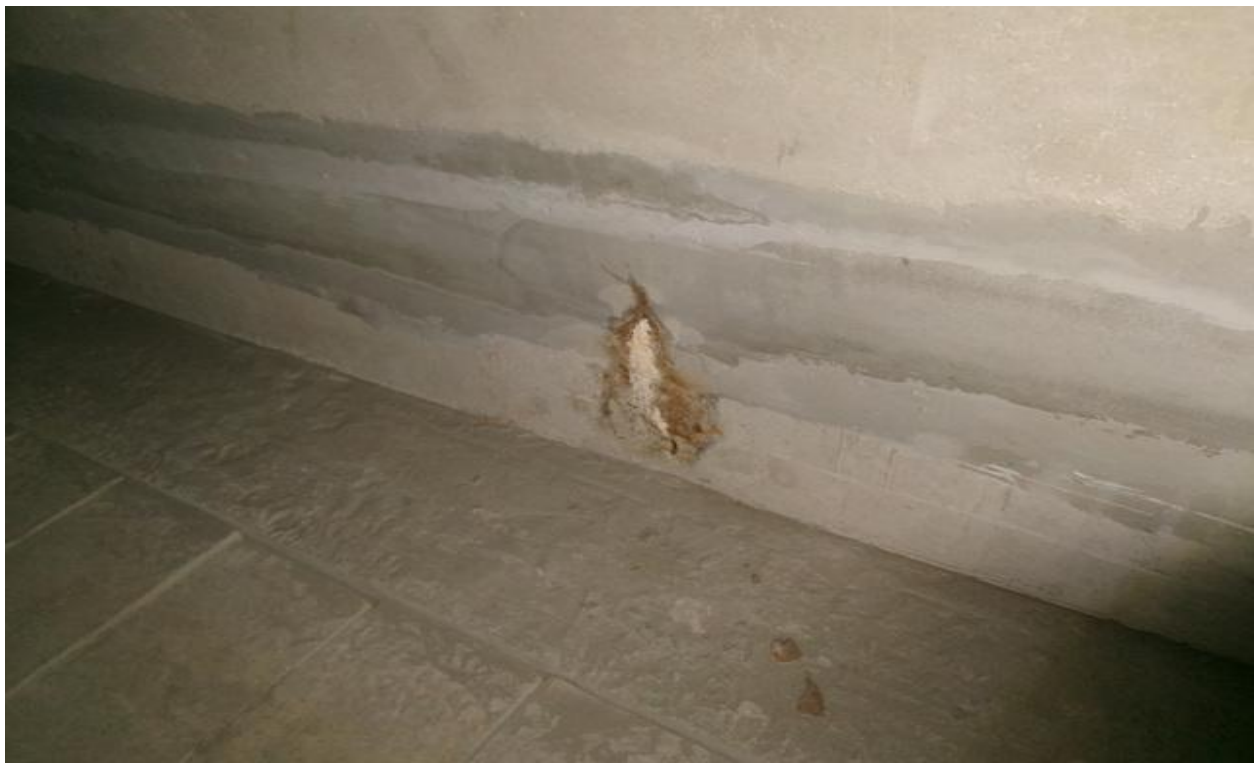
NATM구간 측벽부 S46 내부벽체 균열 및 누수(스며있음)
